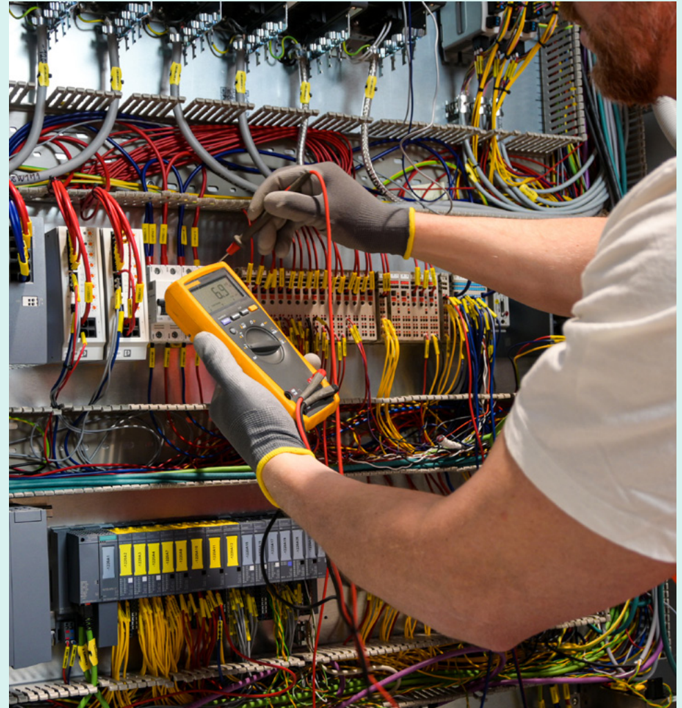
Foto: Doormeten elektra (stock)
